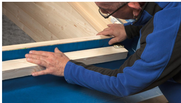
8. SOLITEX WELDANO-S 3000 mit Dehnschleufe in das Kleberbett legen. Kleber dabei nicht ganz flach drücken, damit ggf. Bewegungen aufgenommen werden können.
